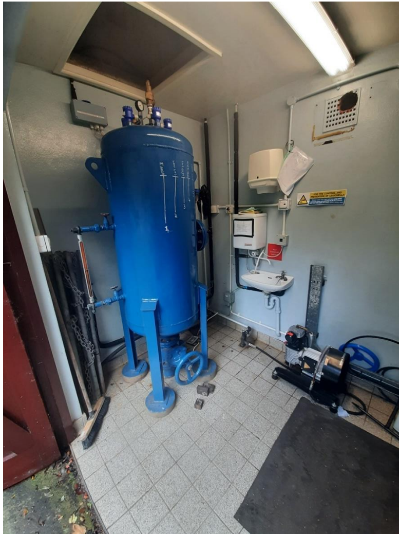
Photo F1 : Rozel 2 surge vessel
